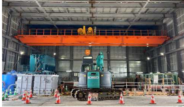
写真-5 10T クラブトロリー式天井走行クレーン
