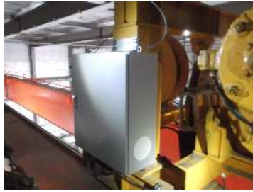
写真-2 処理ユニット
